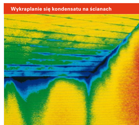
Przebieg temperatury w tym samym narożniku – tutaj może dochodzić do wykraplania się kondensatu
