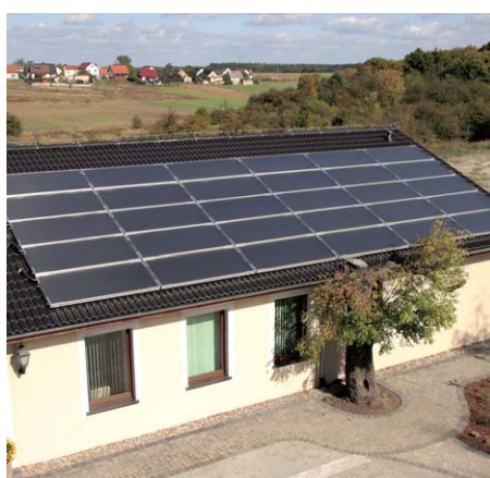
Kolektory Vitosol 100-F ustawione poziomo na dachu.
