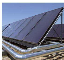
Kolektory Vitosol 300-F ustawione na powierzchni terenu.
