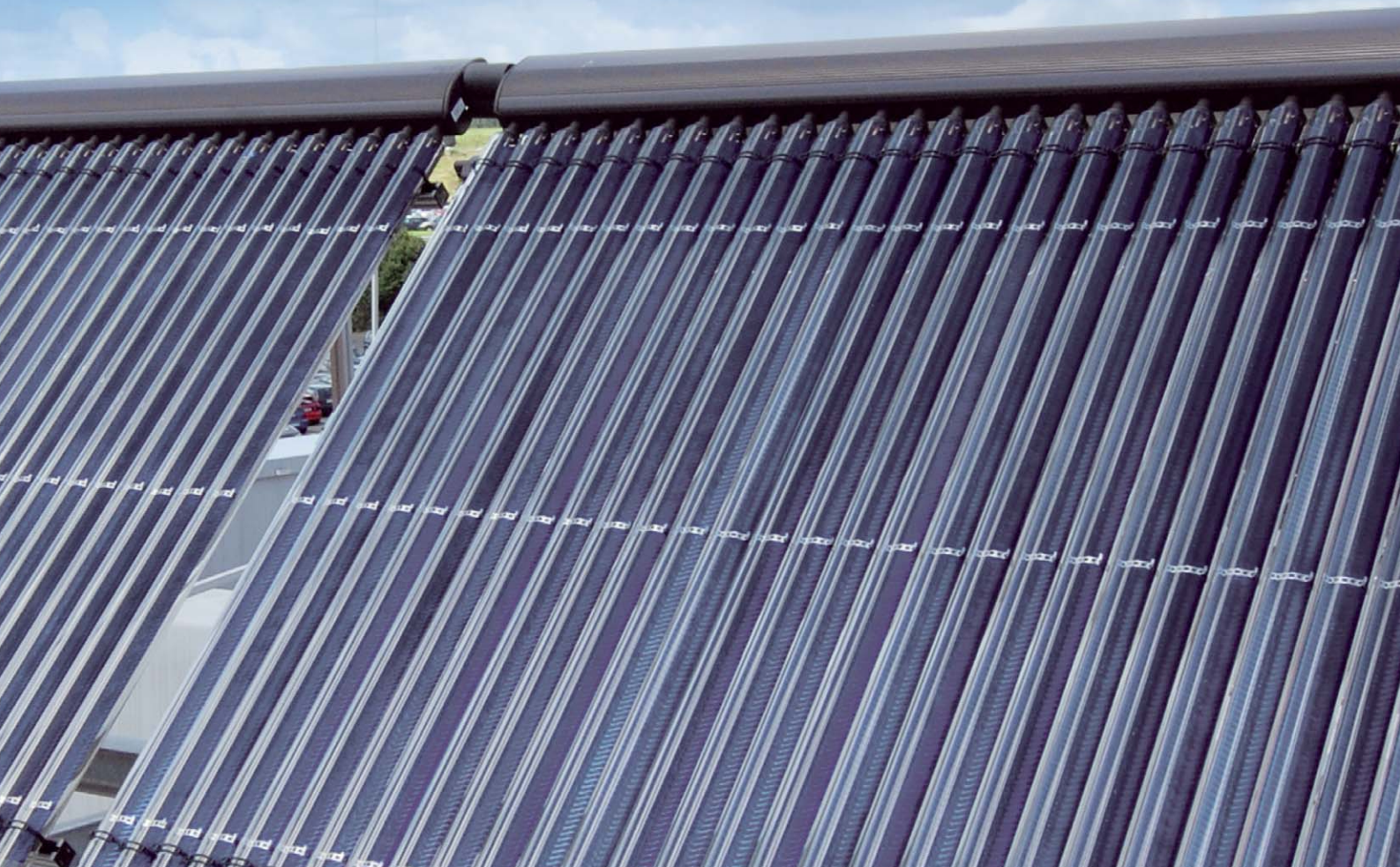
Vitosol 300-T na dachu płaskim.
